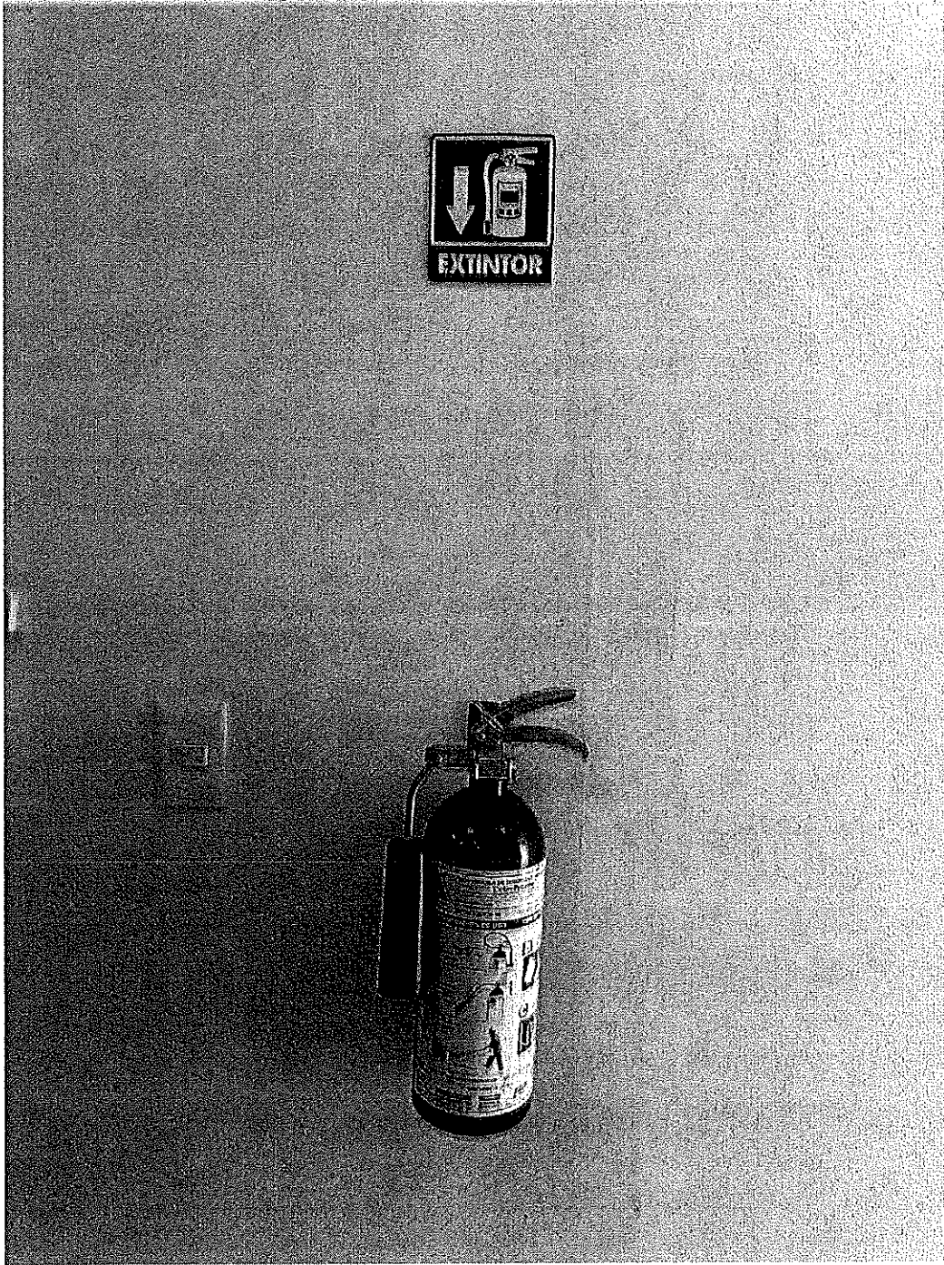
UBICACIÓN: ENTRADA PRINCIPAL PASILLO LADO DERECHO BIÓXIDO DE CARBONO 4.5 KG
