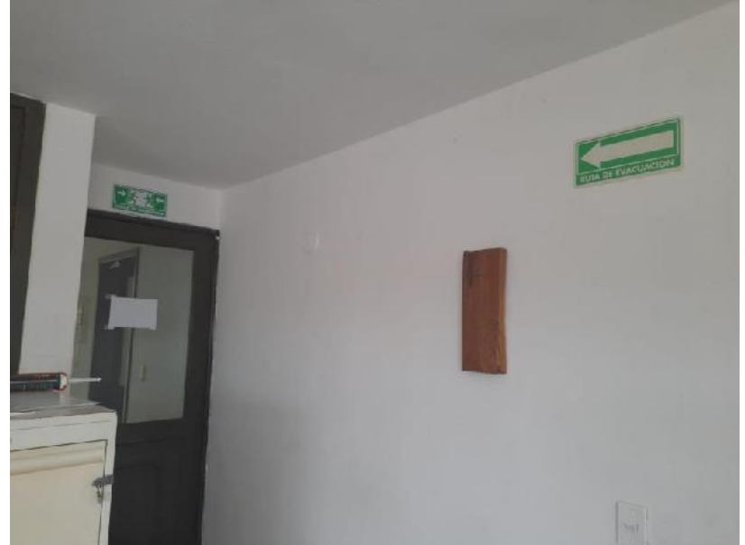
SEÑAL DE RUTA DE AVACUACION Y SALIDA DE EMERGENCIA DE LA DIRECCION DE RELACIONES PUBLICAS
