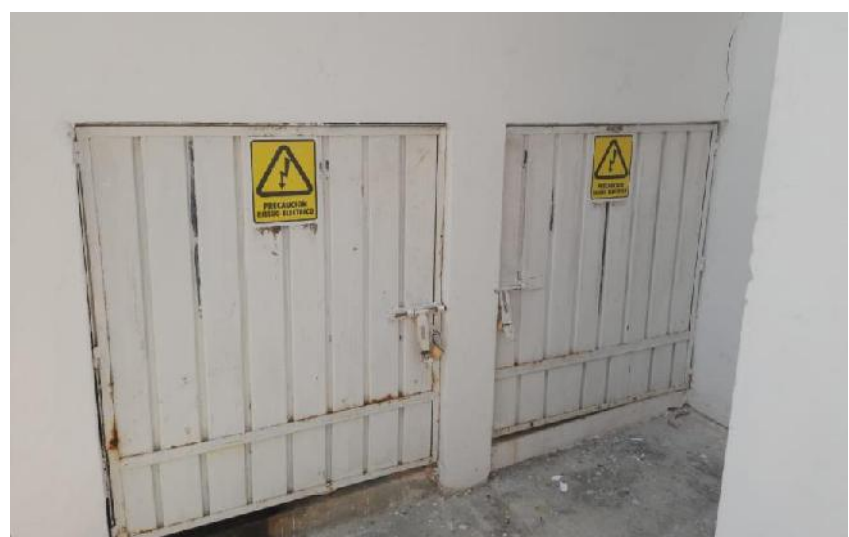
SEÑALES DE RIESGO ELECTRICO EN PUERTA DE ACCESO A CENTROS DE CARGA DE CIRCUITOS ELECTRICOS Y AIRES ACONDICIONADOS
