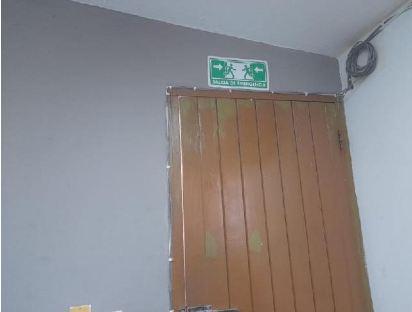
SALIDA DE EMERGENCIA OFICINA DE INFORMATICA EN EL PATIO
