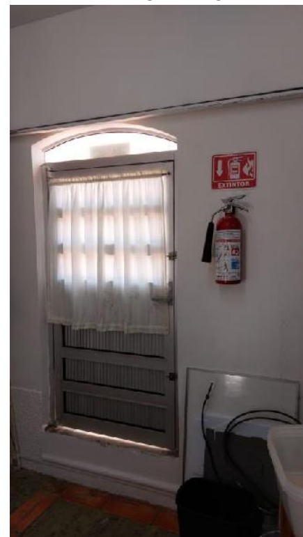
SEÑAL Y EXTINTOR DE CO2 EN EL DEPARTAMENTO DE SERVICIOS GENERALES
