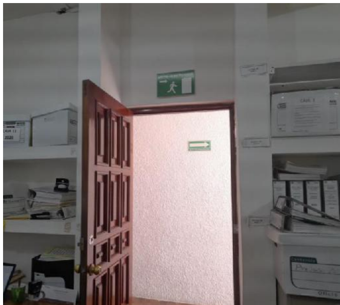
SEÑAL DE SALIDA DE EMERGENCIA DEL DEPARTAMENTO DE RECURSOS HUMANOS Y FLECHA DE RUTA DE EVACUACION EN EL PASILLO PRINCIPAL
