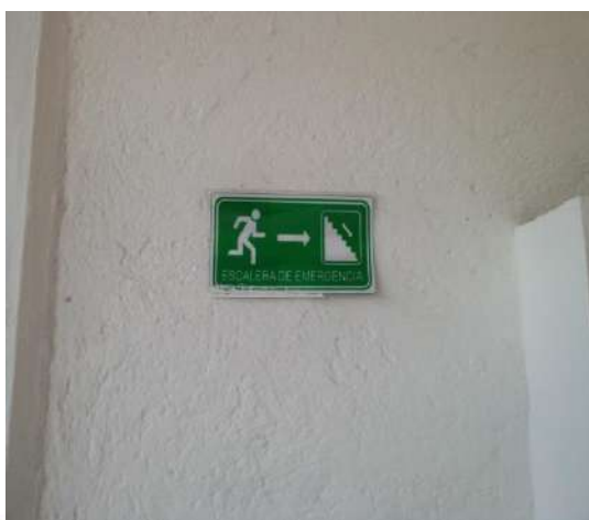
ESCALERA DE EMERGENCIA EMERGENCIA
