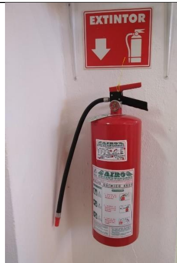
Extintor en pasillo salida
