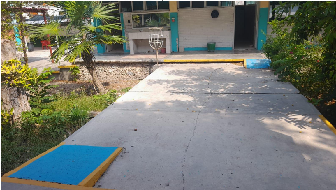
RAMPA DEL DOMO AL TALLER DE DIBUJO, BAÑOS ALUMNOS Y AULAS DE LA 11 A LA 13
