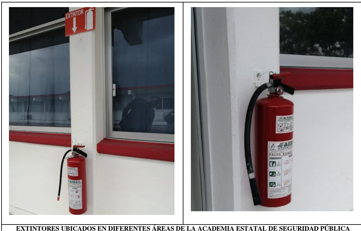
EXTINTORES UBICADOS EN DIFERENTES ÁREAS DE LA ACADEMIA ESTATAL DE SEGURIDAD PÚBLICA
