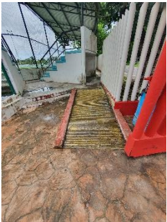
RAMPA PARA DISCAPACITADOS GRADAS DE CAMPO DE BEISBOL
