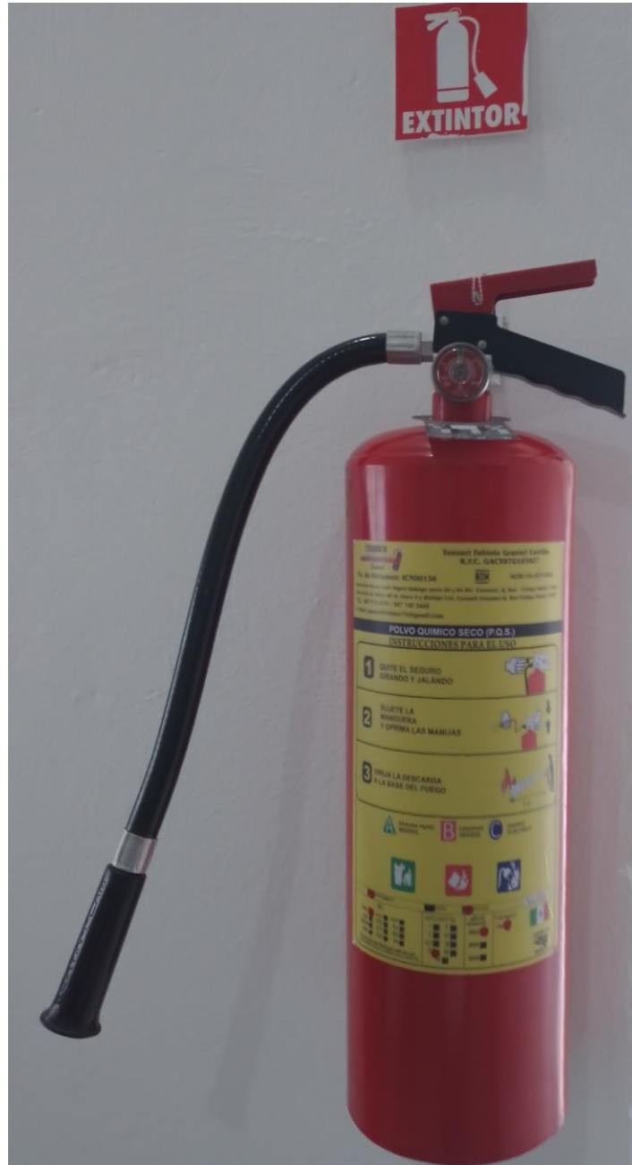
SEÑALIZACION Y EXTINGUIDOR, RECARGADO EN EL AREA DE RECEPCION, AL IGUAL QUE EN EL AREA DE ARCHIVO.
